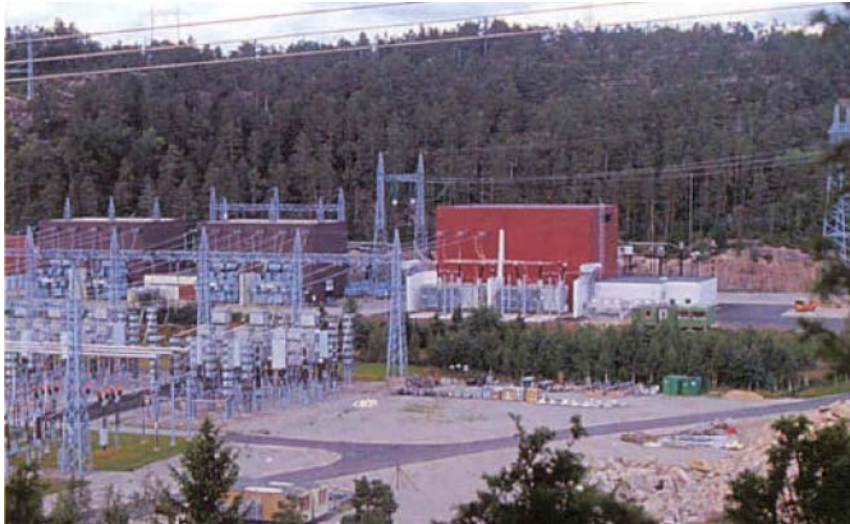
Omformeranlegg for Skagerakforbindelsen – Støleheia (Bildet er hentet fra publikasjonen – Teknisk beskrivelse – NorNed prosjektet).
